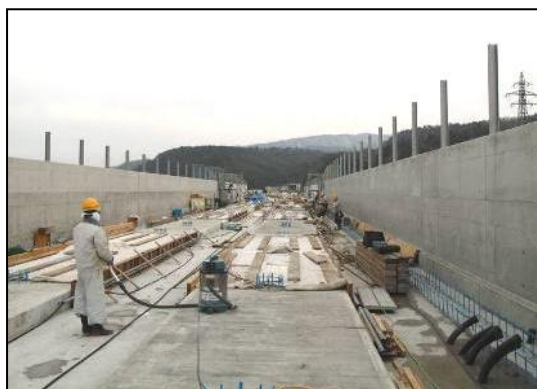
海岸沿いの鉄道線用遮音壁柱
